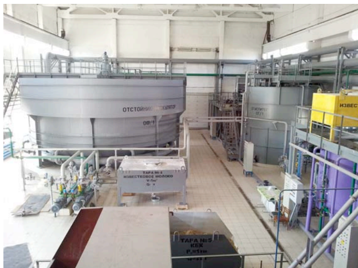
Рис. 2. Сооружения очистки шахтных и подвальных вод медно-цинкового рудника. Блок физико-химической очистки и обезвоживания осадка производительностью 400 м 3 /ч.
