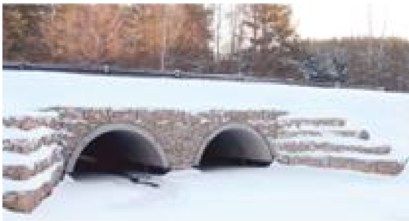
Рис. 5. Двухпролетное водопусковое сооружение с использованием сборных железобетонных арок пролетом 4 м, арочного типа на свайном фундаменте с монолитным железобетонным ростверком.
