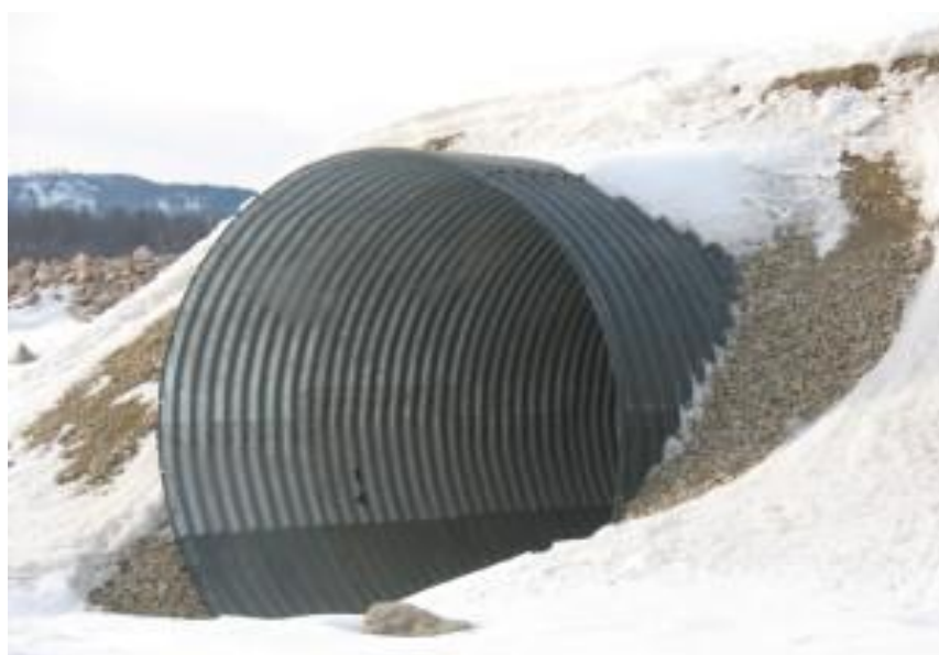
Рис. 1. Металлическая труба на трассе М5.
